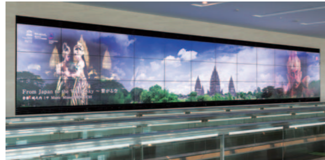
東京国際空港ターミナル株式会社様 羽田空港 国際線旅客ターミナルビルの出発コンコースに36面マルチを設置。映画用のカメラ3台を使い独自の技術で撮影したパノラマ映像などを発信しています。
