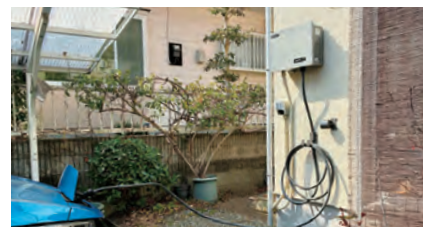
EV用コンバータ (茨城県)
