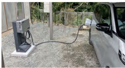
EV用コンバータ (福島県)
