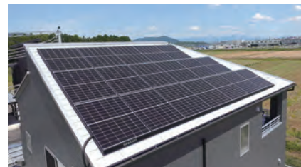
6.99kWシステム (滋賀県)
