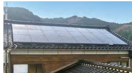
3.96kWシステム (石川県)
