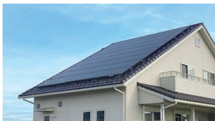
8.80kWシステム (茨城県)
