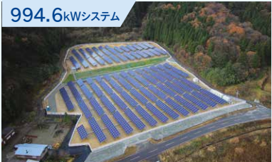
文化シャッター株式会社様（西山太陽光発電所（新潟県柏崎市）
