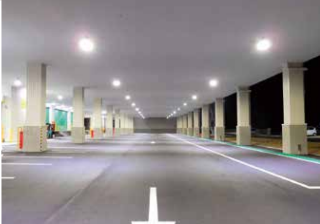
[高天井照明] センコー株式会社様 仙台港 PD センター
