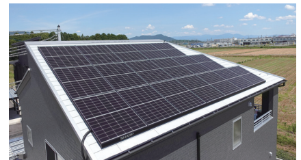
6.99kWシステム (滋賀県)
