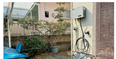
EV用コンバータ (茨城県)
