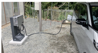
EV用コンバータ (福島県)
