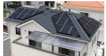
2.98kWシステム (奈良県)
