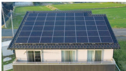
9.89kWシステム (茨城県)
