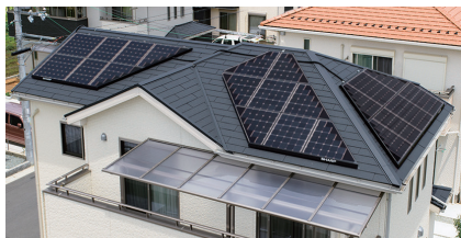
■ 2.98kWシステム (奈良県)
