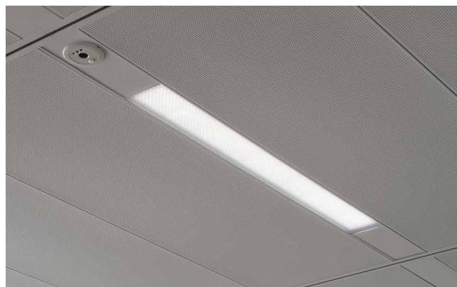
システム天井に組み込まれたオリジナルのLED照明。 オフィス空間では演色性の高い昼白色を採用
