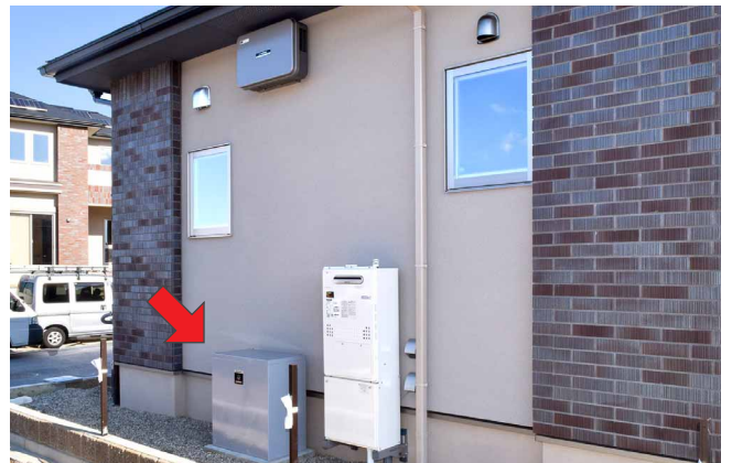
蓄電池がコンパクトに屋外設置できることも採用の決め手に
