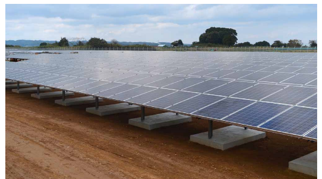
2014年末に大分県国東市で運転開始する、システム発電容量 2.20MWの浜崎第一太陽光発電所
