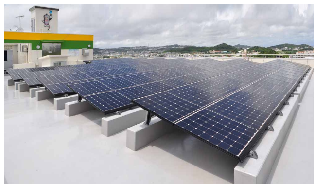
本社屋上には35.1kWの太陽光発電システムを設置
