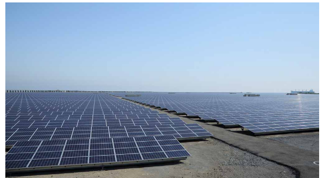
海に近く潮風にさらされるため重塩害対応を採用。夏場の高温のなかでも順調に発電
