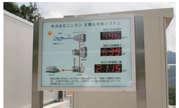
車を降りて見学する方も多く、山道脇に建てた表示パネル
