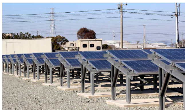
パネルの傾斜角度は10度。発電効率がよく、多少の汚れは雨で流れるのでメンテナンスも簡単
