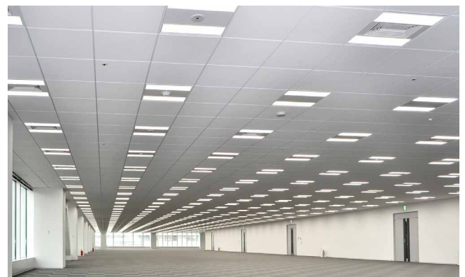
同ビルは全館LED照明を導入（シャープ製です）
