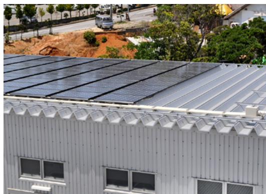
新工場の屋根一面を覆う太陽光パネル
