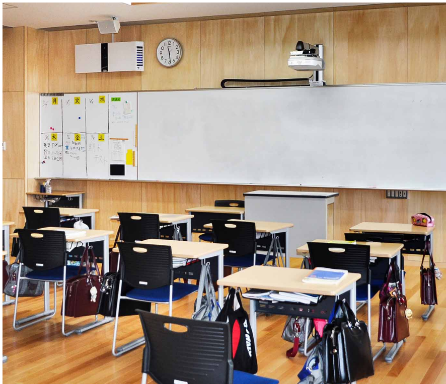
普通教室は左前方と右後方に計2台設置
