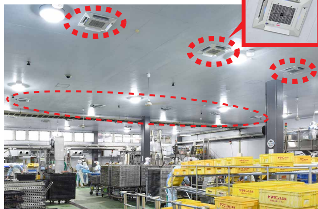
プラズマクラスターで食品を扱う工場内の空気を浄化
