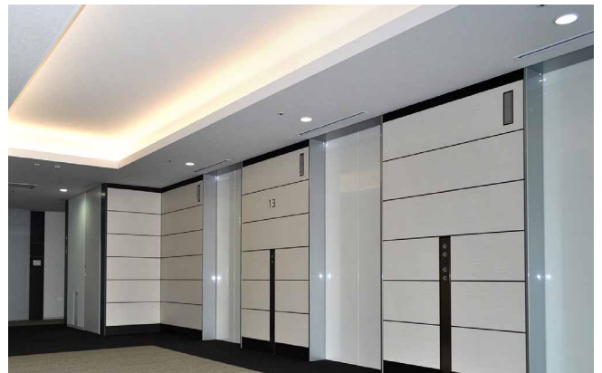
各階エレベータホールにベースダウンライトを設置
