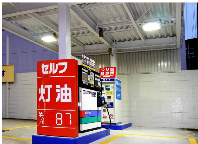
灯油の給油機の上にも2台のLEDキャノピー灯
