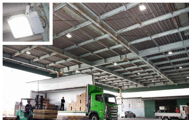
軒下には防水仕様の投光器。明るく、積み下ろし作業もスムーズ
