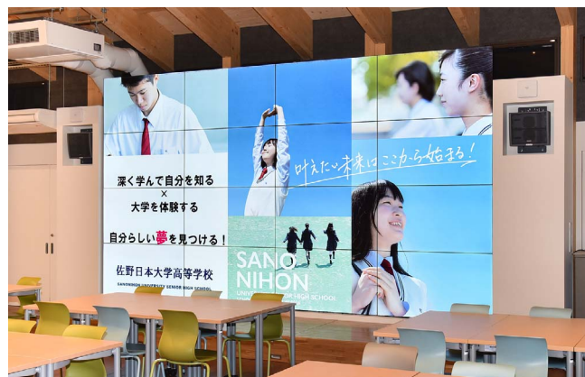
多目的スペースの壁面に16面マルチディスプレイを設置
