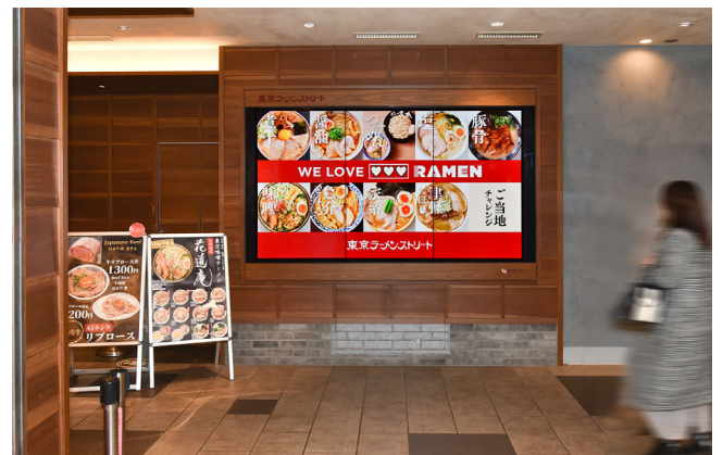
東京ラーメンストリートには液晶60V型の3連設置 (2025年2月導入)
